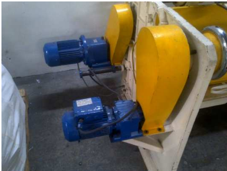
1. Guarda protectora de correas de motores
